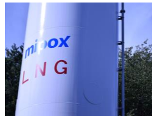
LNG (Liquefied Natural Gas) boiler
